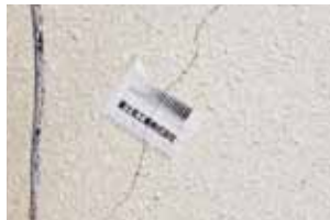
ひび割れ 写真提供：富士見工業(株)
